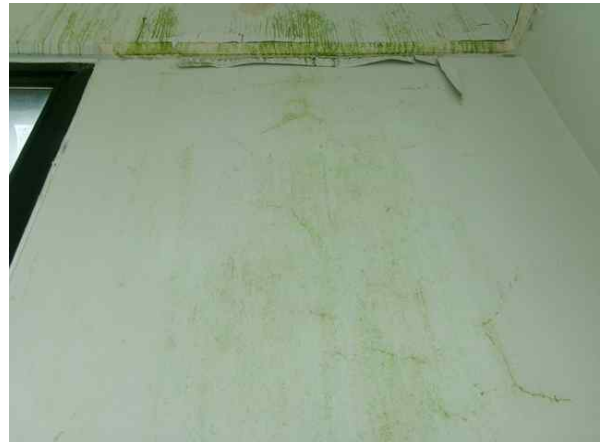
손상내용 검수실 내부 벽체 망상균열 손상원인 건조수축 등
