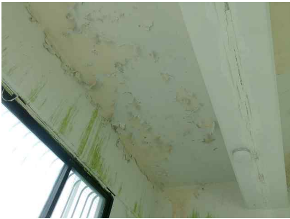
손상내용 검수실 내부 상부슬래브 도장박리 손상원인 공용중 열화 등
