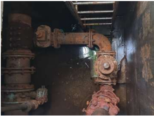
손상내용 유입밸브실(1지) 관부식 손상원인 공용기간 증가 등
