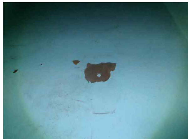
손상내용 2지 바닥슬래브 도장박리 손상원인 공용중 열화 등
