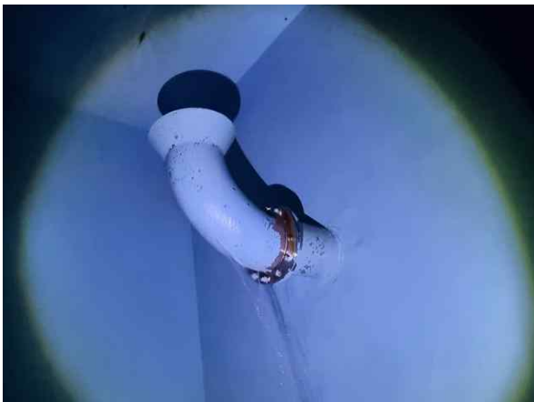
손상내용 2지 유입 배관 현황 손상원인 -
