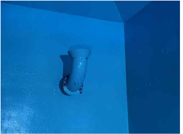
손상내용 1지 유입 배관 현황 손상원인 -
