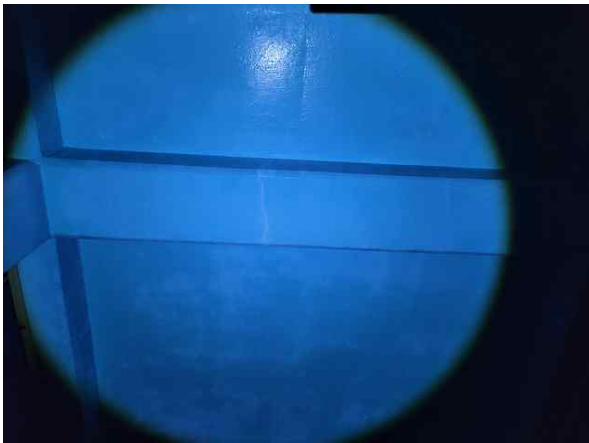
손상내용 1지 상부슬래브 균열 손상원인 건조수축 등
