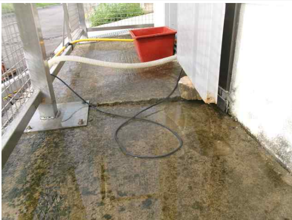
손상내용 검수실 외부 바닥 이격 단차 손상원인 시공미흡 등
