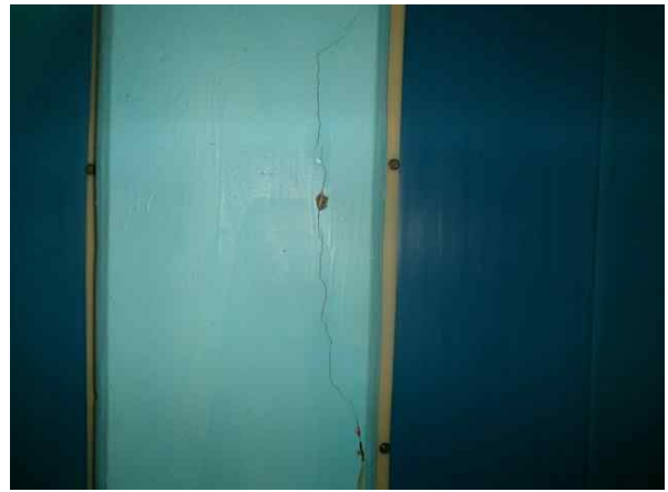
손상내용 2지 기둥 균열부 백태 손상원인 건조수축+습윤침투 등
