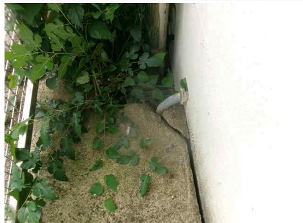
손상내용 검수실 외부 바닥 파손 손상원인 건조수축, 온도변화 등
