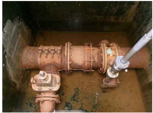
손상내용 유입밸브실(2지) 관부식 손상원인 온도차에 따른 습기흡착 등
