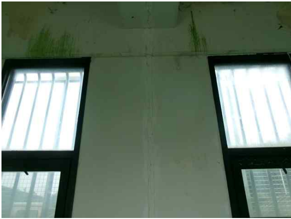
손상내용 검수실 내부 신축이음 불량 손상원인 시공미흡 등
