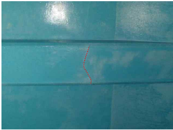
손상내용 2지 상부슬래브 균열 손상원인 건조수축 등
