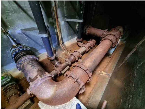
손상내용 통합유출밸브실 관부식 손상원인 온도차에 따른 습기흡착 등
