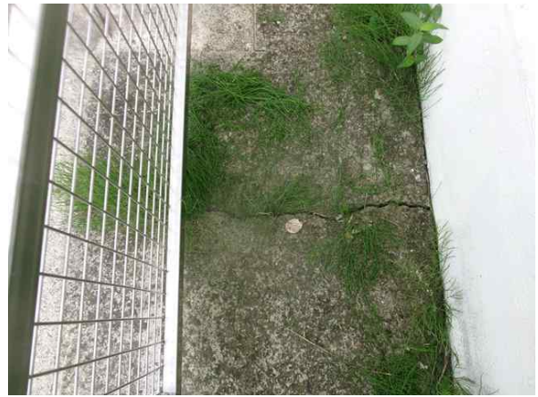
손상내용 검수실 외부 바닥 균열 손상원인 건조수축, 온도변화 등
