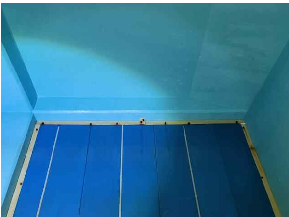
손상내용 1지 도류벽 볼트부식 손상원인 습윤접촉 등
